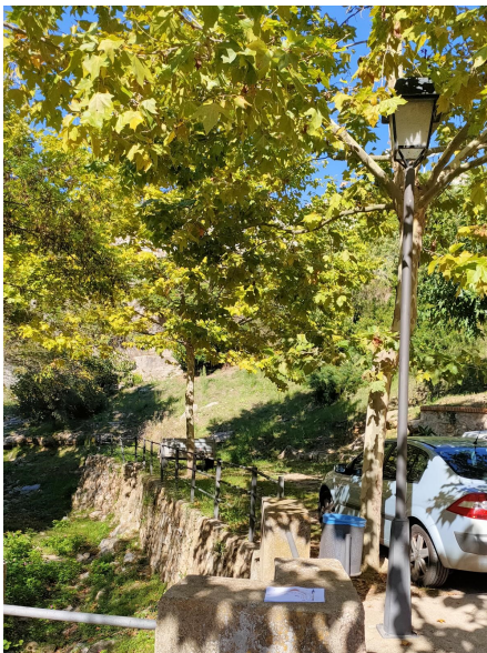
Farola de connexió de la prolongació de l'enllumenat públic
